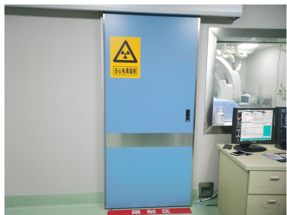
图 4-7 控制室铅门、警示标志
